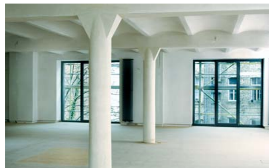
Bei Fensterlaibungen zählt jeder Millimeter. Hier empfiehlt sich der Einsatz von innovativen, besonders schlanken Innendämmsystemen auf der Basis von Vakuum-Paneelen.
