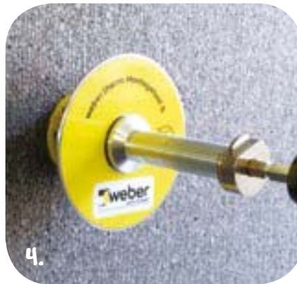
Bohrloch erstellen, Dübel einstecken, bis er auf dem Dämmstoff aufliegt. Mit dem weber.therm SRD Montagetool S verschrauben und versenken.
