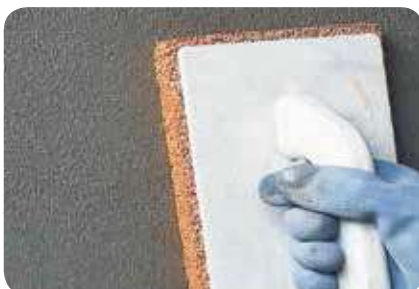
4. Zum Durchreiben der weber.therm Armierungsmörtel z.B. für Faschen, wird ein Schwammbrett empfohlen.
