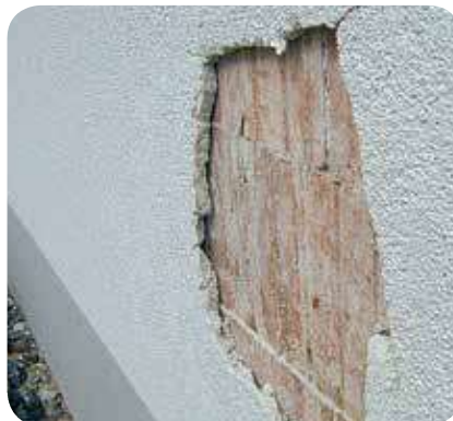
2. Schäden durch einen feuchten Putzgrund
