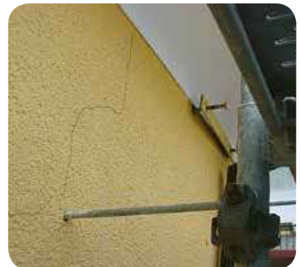
3. Riss aufgrund statischer Mängel des Leichtmauerwerks
