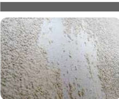
1. Schlechte Witterung – auch wenn sie erst nach der Verarbeitung einsetzt – kann das Abbinden erheblich verzögern. Dies kann auch mehrere Tage nach der Verarbeitung zu Schäden am Putz führen.
