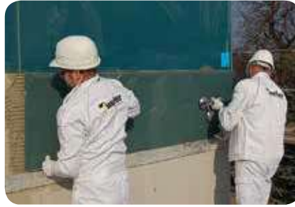
17. Die Glaselemente müssen unverzüglich nach Kleberauftrag montiert werden. Bei großen Elementen erleichtern Stützkonstruktionen oder Keile das exakte Positionieren
