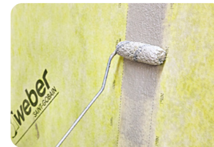
11. Stoßbereiche mit weber.tec 824 überarbeiten. In chemisch beanspruchten Bereichen weber.tec 827 S für diesen Arbeitsschritt verwenden.
