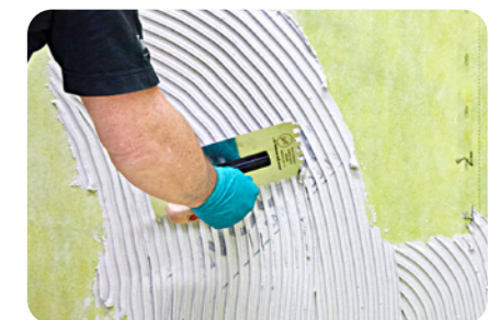
15. Auf der Abdichtungsschicht kann bei Raumtemperatur nach ca. 18 Stunden mit den Verlegearbeiten begonnen werden.
